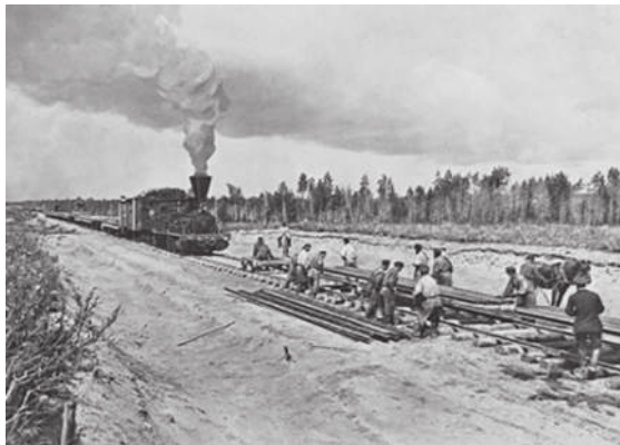
Строительство Транссиба велось в сложных условиях. Фото из книги «Великий путь. Виды Сибири и Великой Сибирской железной дороги». Красноярск, 1899.
